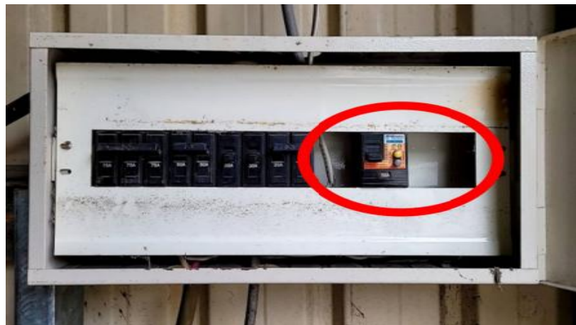
良好樣態-缺漏電斷路器及中隔板
