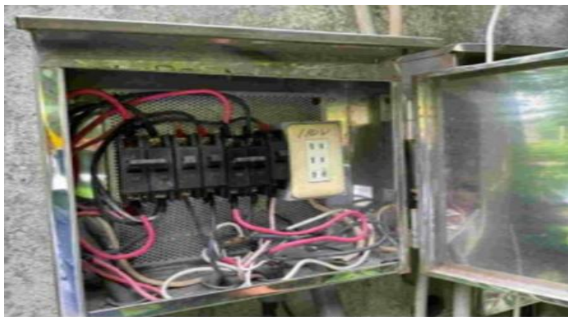
常見缺失樣態-缺漏電斷路器及中隔板
