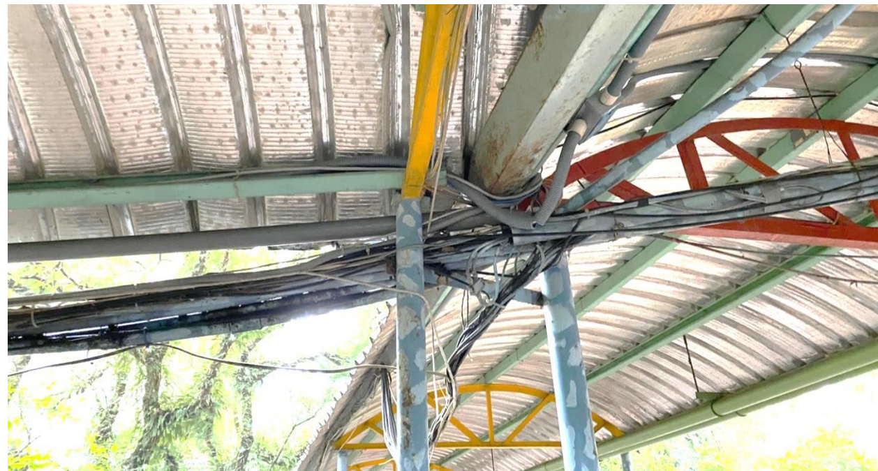
2 管線老舊凌亂
