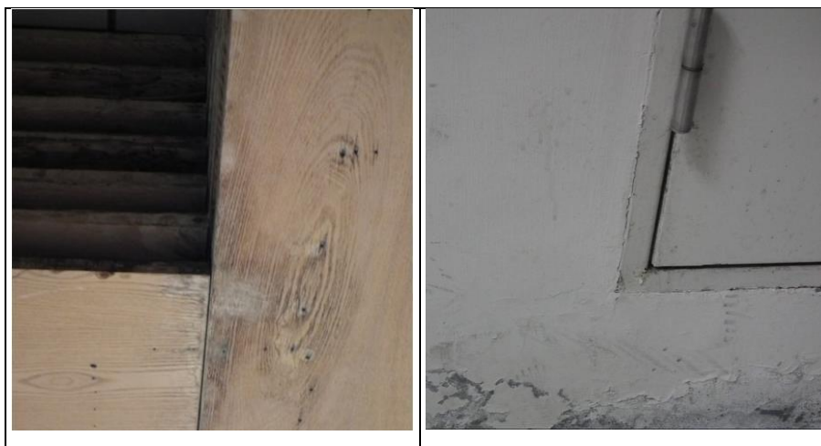
圖 10 室內建材孳生黴菌及牆面壁癌
