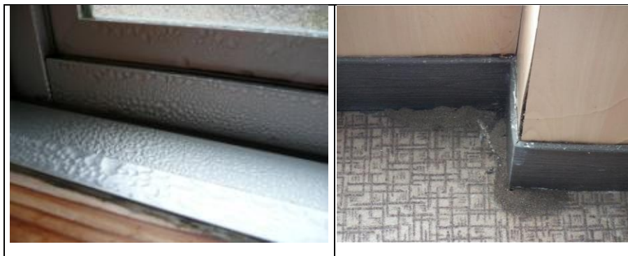
圖 9 窗台冷凝問題及木質裝潢蛀蝕情形
