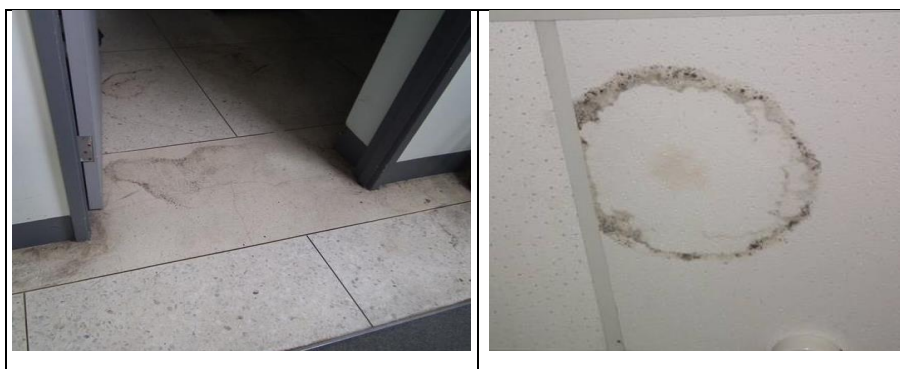
圖 8 室內環境積水或滲水所殘留水漬情形
