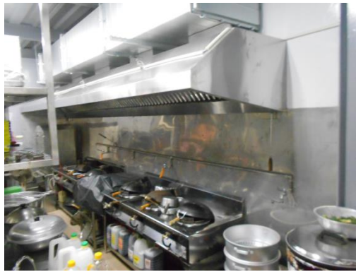
圖 16 廚房排氣裝置
