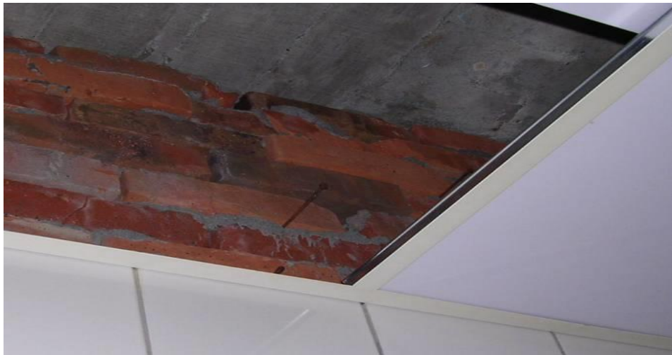
〈照片七〉 隔間牆粉刷層未施做至版底
