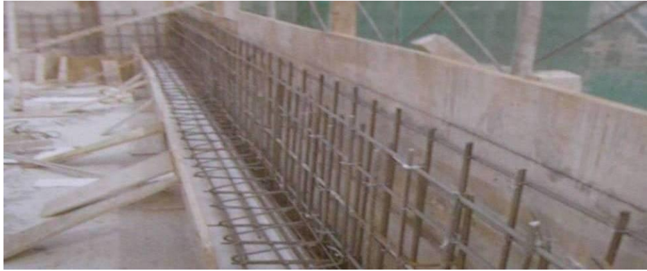
〈照片一〉 泛水與女兒牆應一體施工
